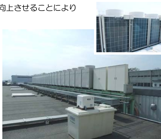
埼玉工場噴霧装置
