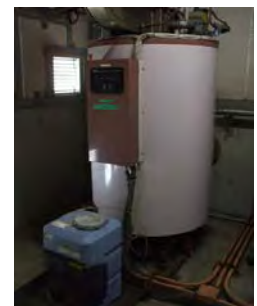
切替前： プロパンガス 燃焼式ボイラー
