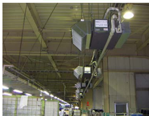
電気式空調機
